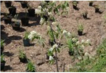
Ogród deszczowy w Kamieńcu
